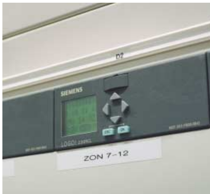
BELYSNINGSSYSTEMETS HJÄRTA utgörs av ett skåp som rymmer tre PLC-enheter från Siemens med vardera sex tidkanaler.
