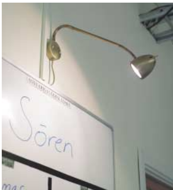
TILLÄGGSBELYSNING. Sorteringshallens enda tilläggsbelysning är monterad över en anslagstavla.
